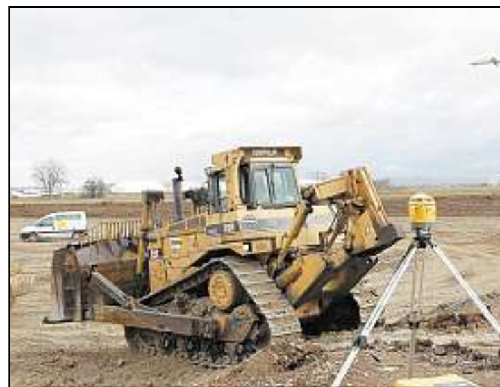
Les travaux pour l'installation d'un pôle de maintenance et d'aménagement d'avions ont débuté. Photo Denis Sollier
